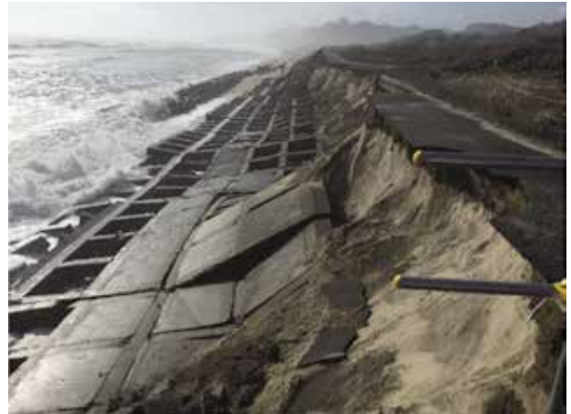
茨城県 赤浜地区海岸の被災状況（写真提供：茨城県）
