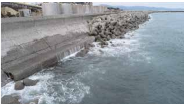
三重県 鵜殿港海岸の被災状況（写真提供：三重県）
