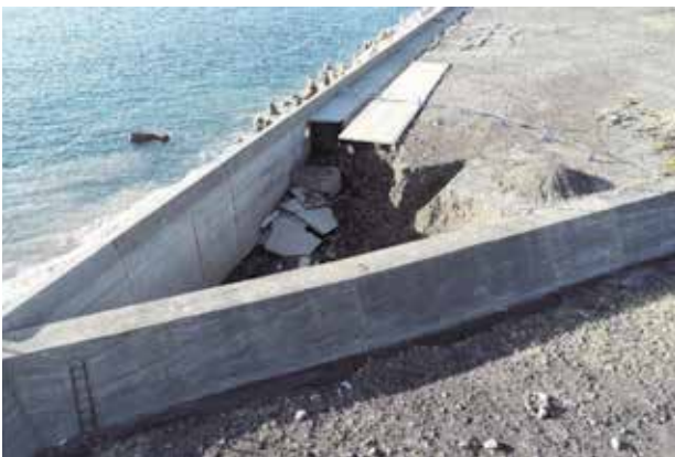
長崎県 高島西海岸の被災状況（写真提供：長崎県）
