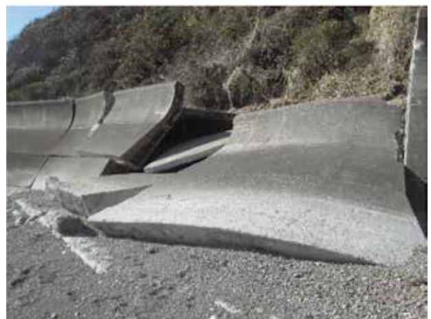
高知県 入木海岸の被災状況（写真提供：高知県）
